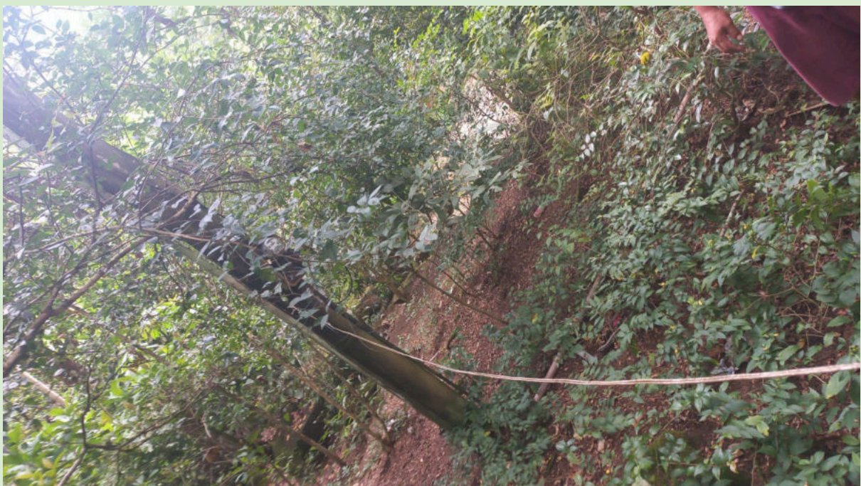
Imagem - Fiação na altura da cintura de moradores localizada no meio da comunidade
