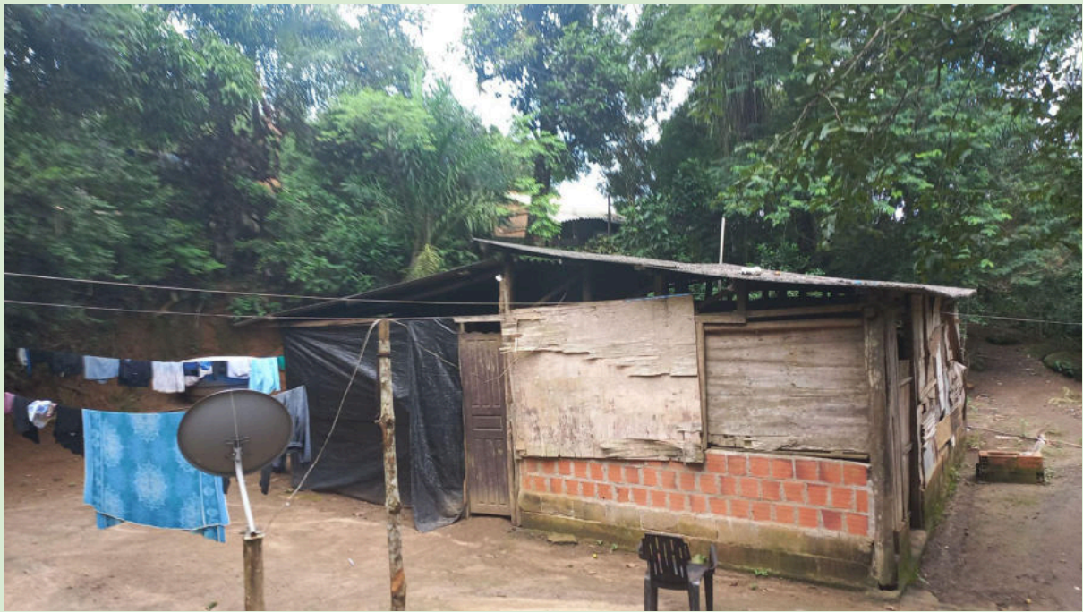
Imagem - Fiação elétrica que passa por dentro da casa de morador devido a sua altura diminuta
