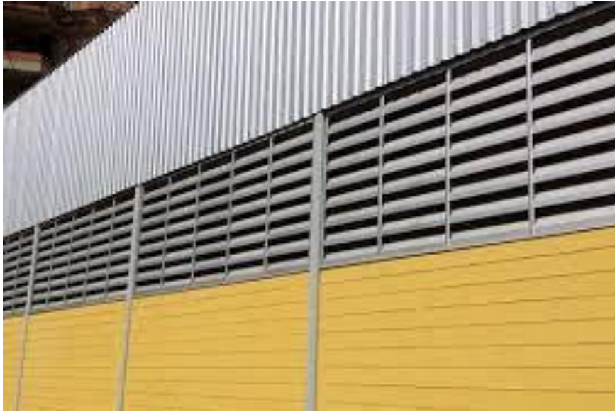
Figura 5: Sistema de ventilação natural com veneziana industrial.
