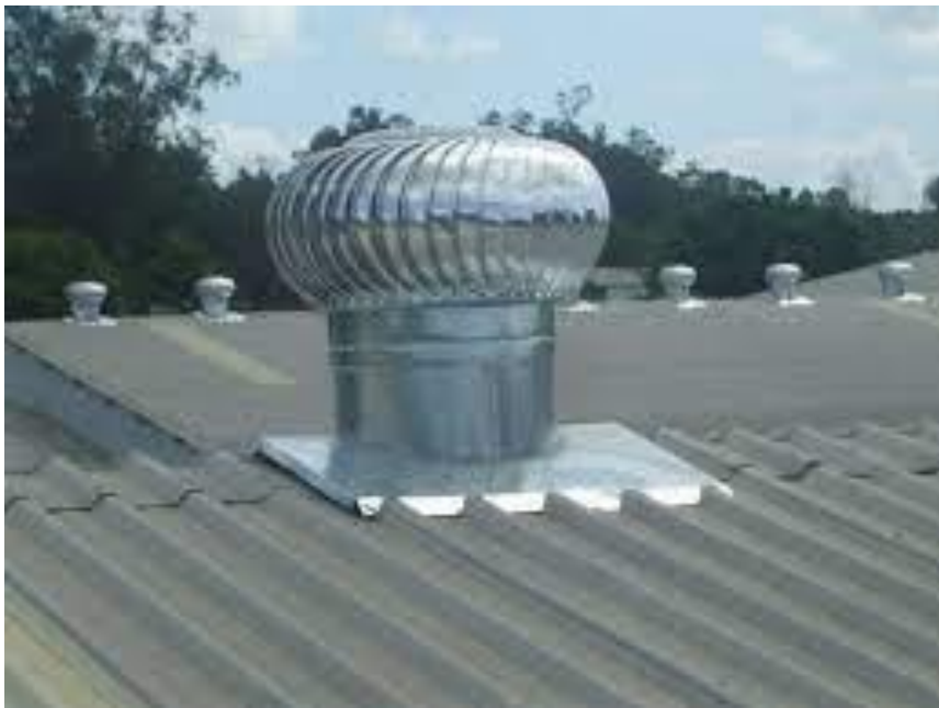
Figura 4: Sistema de exaustão eólica.
