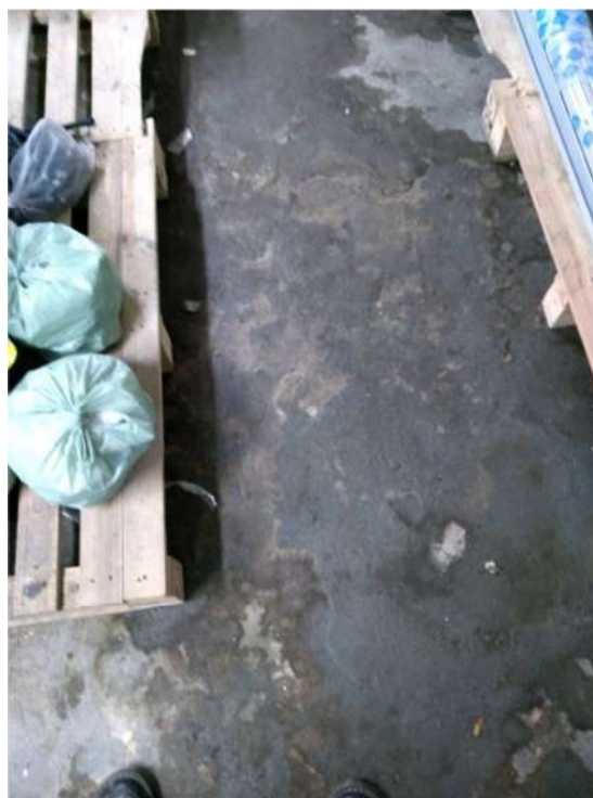
FOTO 76 – DETALHE TÍPICO DA INFILTRAÇÃO NO PISO DENTRO DAS SALAS
