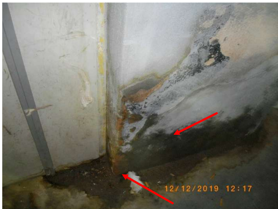
FOTO 36 - INFILTRAÇÃO NO CANTO ESQUERDO DO PISO E DO PILAR 15 - COM REPARO
