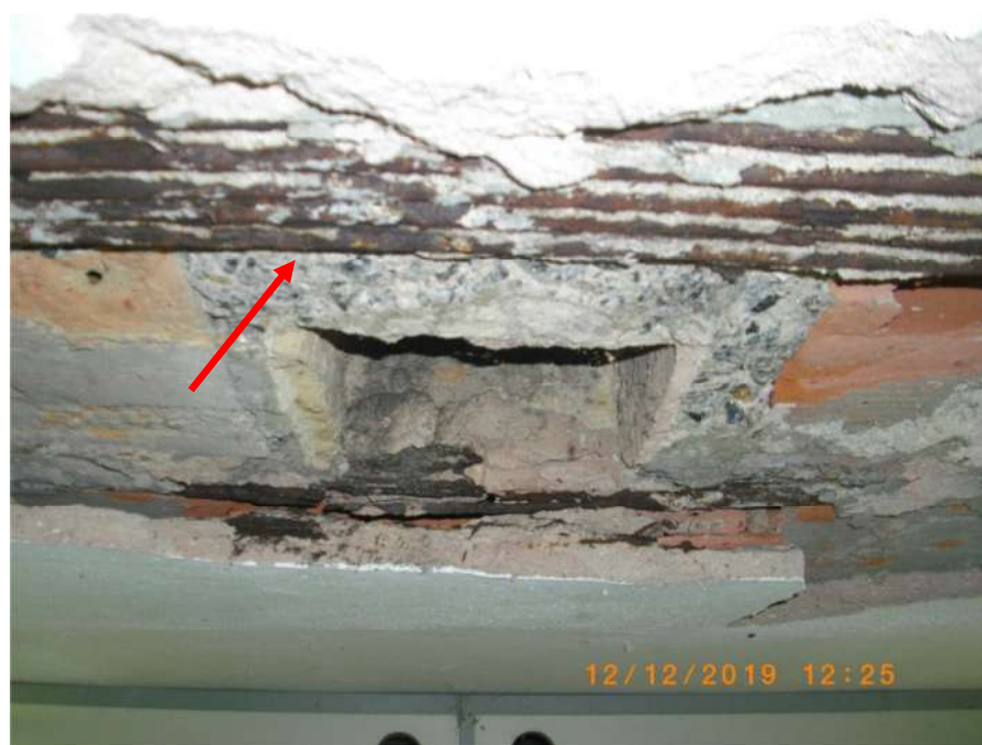
FOTO 40 - 2º TRECHO - CONCRETO DESAGREGADO E ARMADURA OXIDADA EXPOSTA NAS VISITAS NO TETO DA SALA ACIMA
