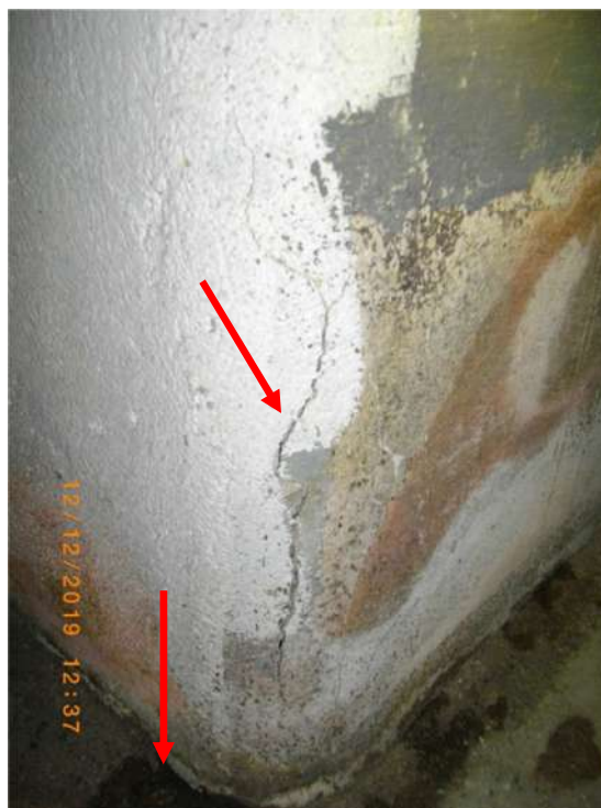
FOTO 58 - INFILTRAÇÃO E FISSURA NO CANTO FRONTAL DIREITO JUNTO AO PISO NA CISTERNA DA ESQUERDA NA MESMA ÁREA
