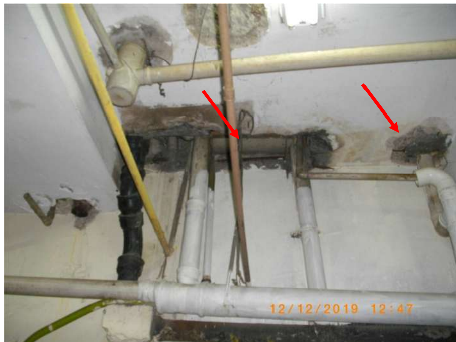
FOTO 70 - MAIS DANOS E INFILTRAÇÕES NESTA LAJE (TB PRÓX AO PILAR 07)
