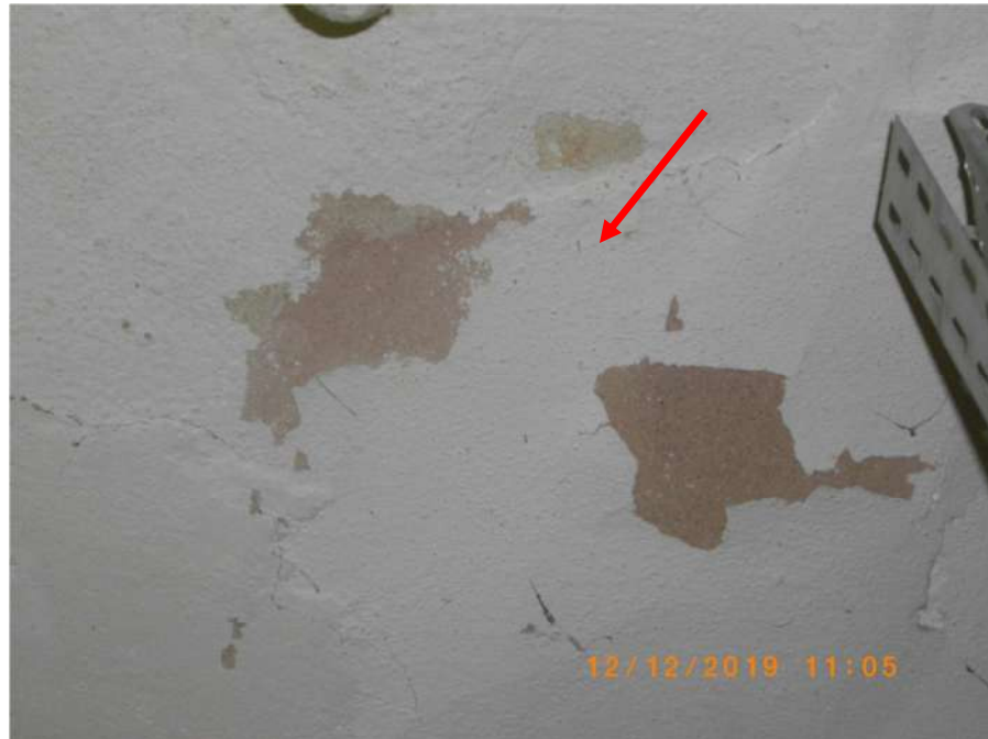
FOTO 03 - PULVERULÊNCIA NO TETO DA 1ª SALA DA SERRALHERIA
