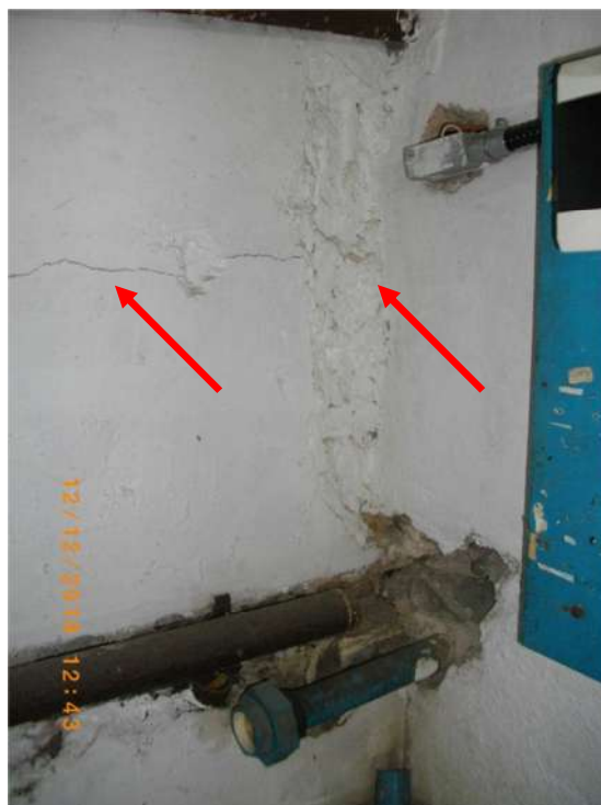
FOTO 66 - CONTINUAÇÃO DA FISSURA ACIMA NO CANTO DIREITO DESTA PAREDE E DANOS NÃO ESTRUTURAIS
