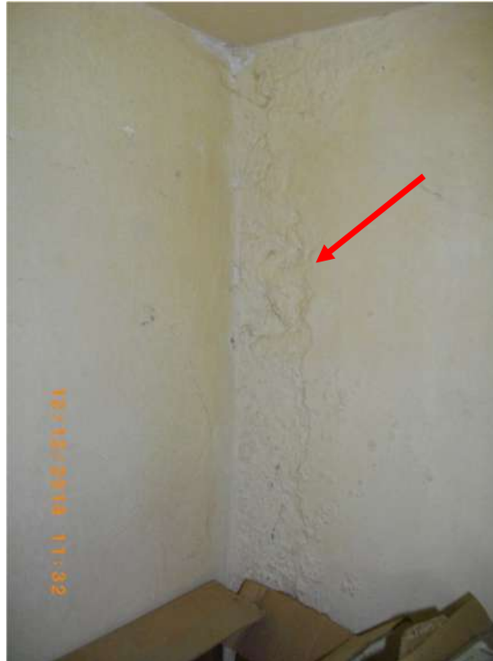
FOTO 17 - DANOS NÃO ESTRUTURAIS NO CANTO ESQUERDO DA PAREDE DE FUNDOS DA SALA ANTES CITADA
