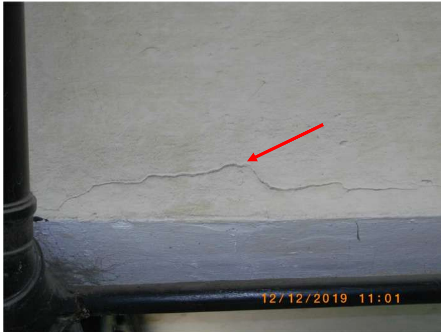
FOTO 01 - FISSURA TRANSPASSANTE À ESQUERDA NO 1º TRECHO DA VIGA 01
