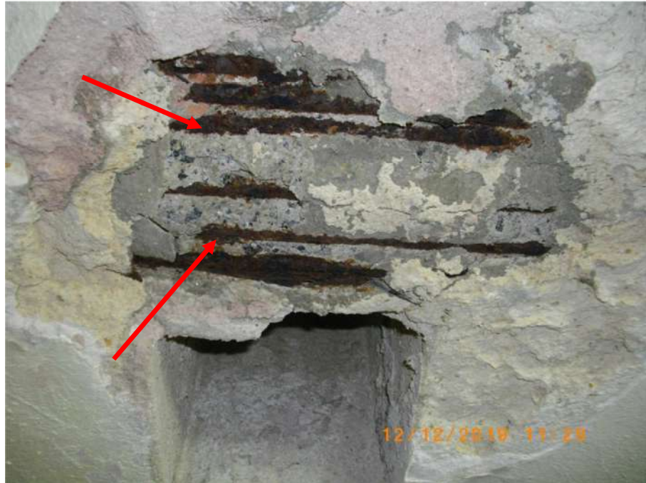
FOTO 15 - CONCRETO DESAGREGADO E ARMADURA OXIDADA EXPOSTA NA 3ª VISITA NO TETO DA SALA ANTERIORMENTE CITADA
