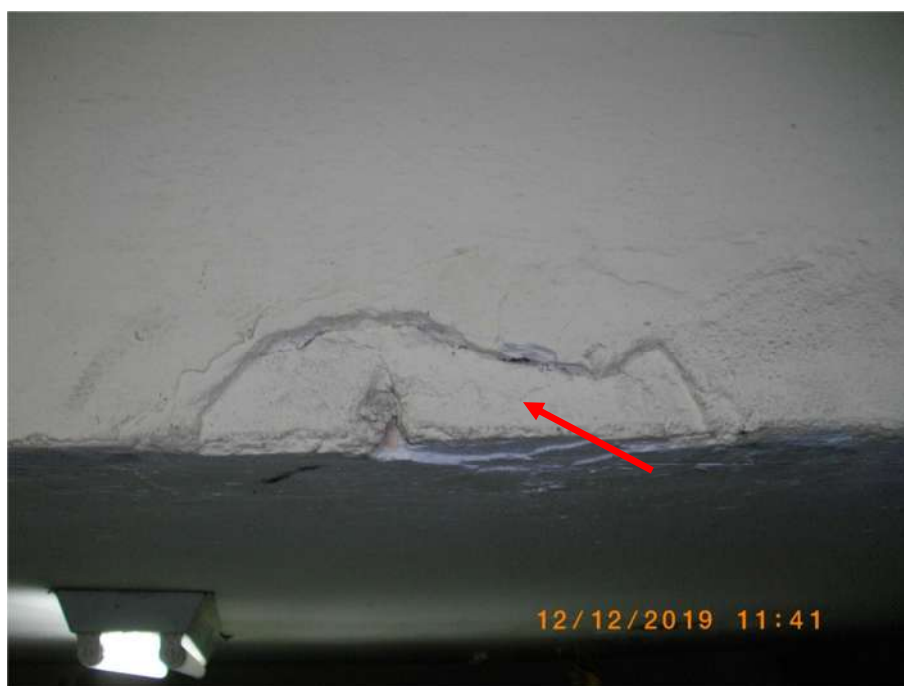
FOTO 20 - DANOS NÃO ESTRUTURAIS NO 2º VÃO DA VIGA 02 NA MESMA ÁREA ACIMA
