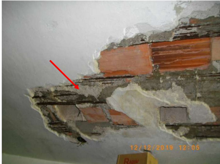
FOTO 31 - TRECHO INICIAL - CONCRETO DESAGREGADO E ARMADURA OXIDADA EXPOSTA NAS VISITAS NO TETO DA SALA ANTES CITADA
