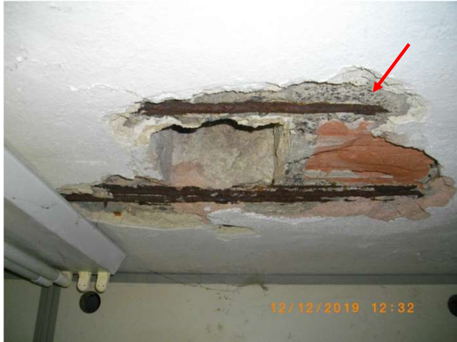
FOTO 49 - 1º TRECHO - CONCRETO DESAGREGADO E ARMADURA OXIDADA EXPOSTA NAS VISITAS NO TETO DA SALA ANTES CITADA
