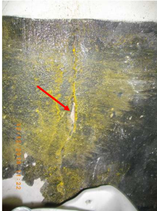
FOTO 11 - TRINCA EM OUTRO TRECHO DA PAREDE ANTERIORMENTE MENCIONADA
