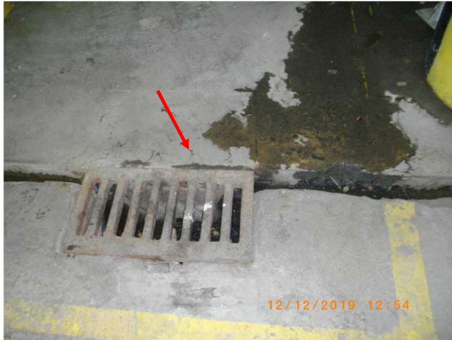
FOTO 73 - DANOS NA CANALETA DO PISO DO SUBSOLO (PRÓX AO PILAR 03)
