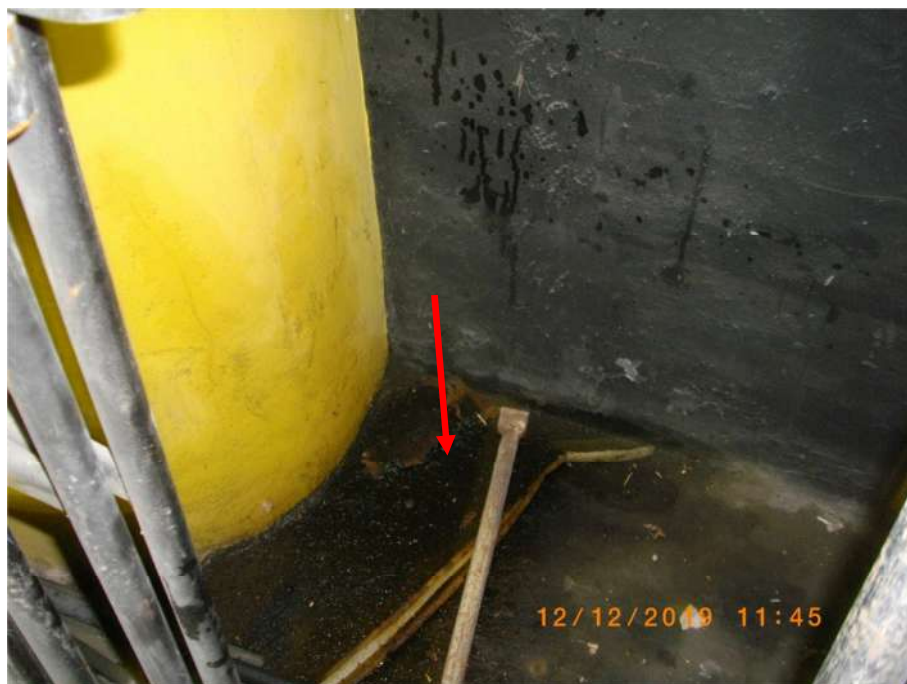
FOTO 22 - EMPOÇAMENTO NO PISO EM CONSEQUÊNCIA À INFILTRAÇÃO NO CANTO DIREITO DO PILAR 21
