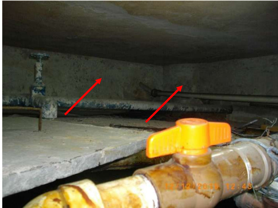
FOTO 63 - INFILTRAÇÃO NA PAREDE DE FUNDOS NA LATERAL DIREITA DA SALA ANTES MENCIONADA
