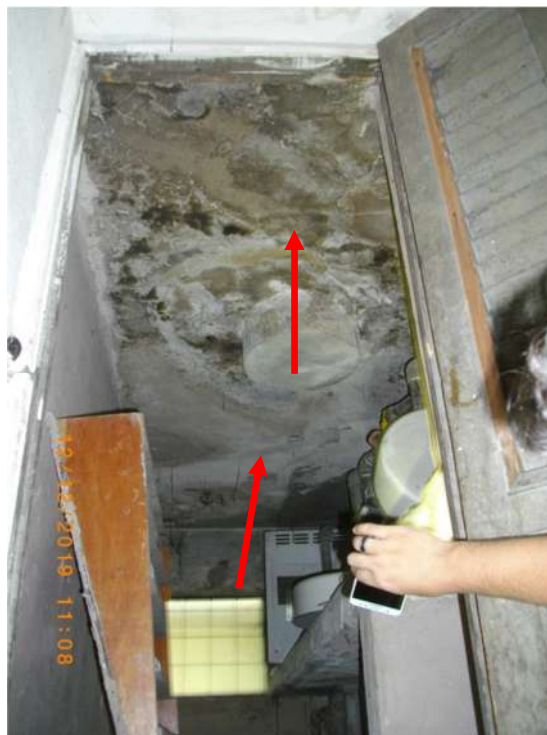
FOTO 04 - INFILTRAÇÃO GENERALIZADA NO TETO DO ANEXO DA 2ª SALA DA SERRALHERIA
