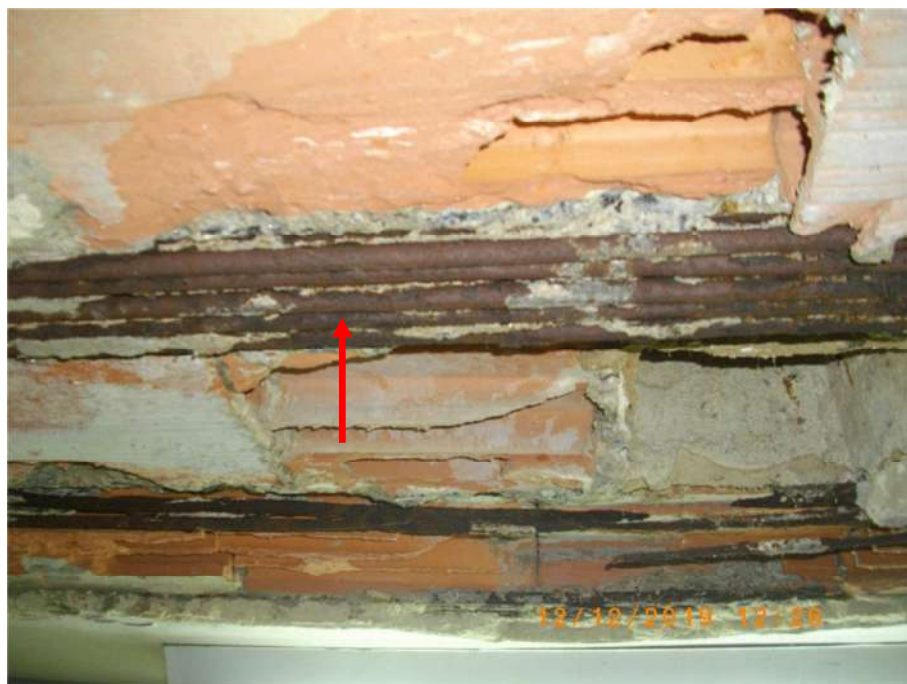
FOTO 42- 4º TRECHO - CONCRETO DESAGREGADO E ARMADURA OXIDADA EXPOSTA NAS VISITAS NO TETO DA SALA ACIMA
