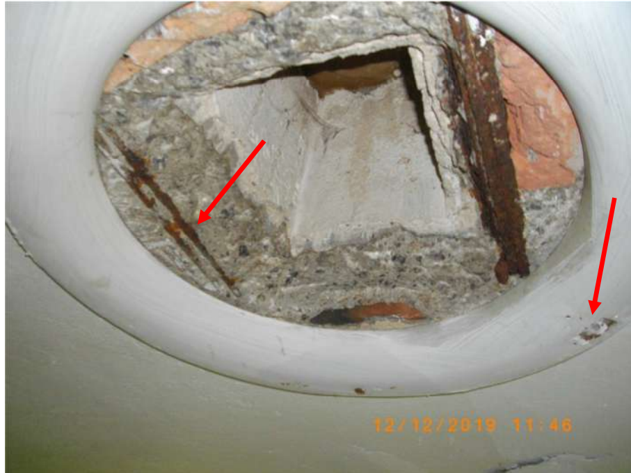
FOTO 23 - ARMADURA OXIDADA EXPOSTA NA 4ª VISITA NO TETO DA ÁREA ENTRE O FERRAMENTAL E O DEP. TRANS. (PRÓX. AO P 21)
