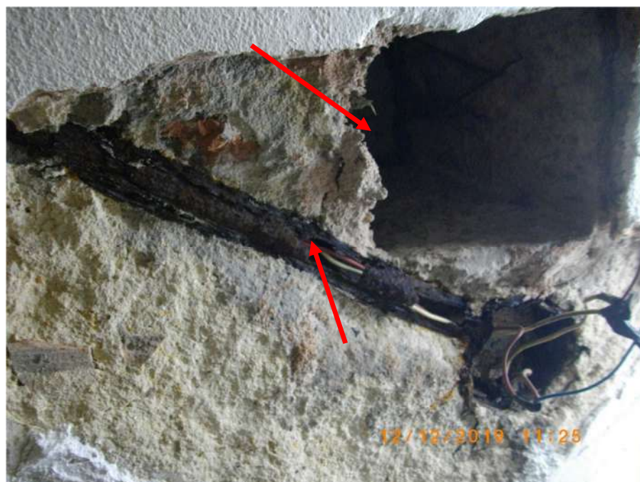
FOTO 12 - CONCRETO DESAGREGADO E CONDUÍTE OXIDADO NA 4ª VISITA NO TETO DA 4ª SALA DA SERRALHERIA
