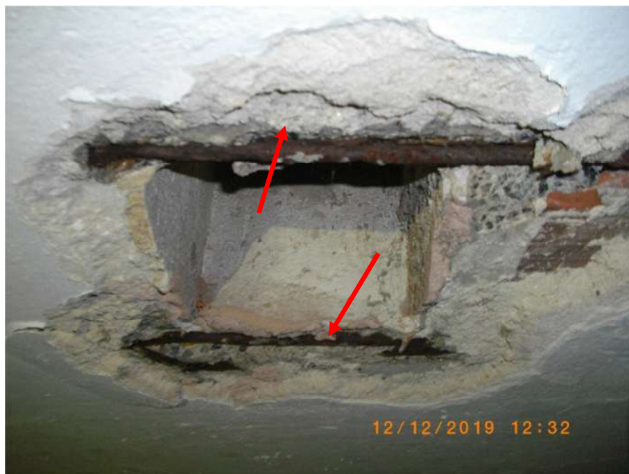
FOTO 50 - 2º TRECHO - CONCRETO DESAGREGADO E ARMADURA OXIDADA EXPOSTA NAS VISITAS NO TETO DA SALA ACIMA
