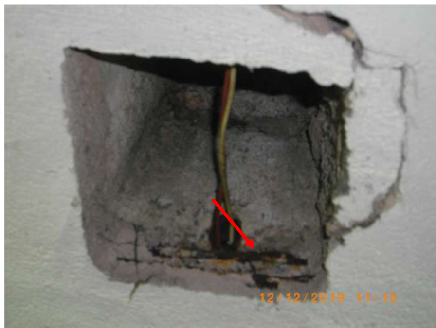
FOTO 08 - ARMADURA OXIDADA EXPOSTA NA 2ª VISITA NO TETO DA SALA ACIMA
