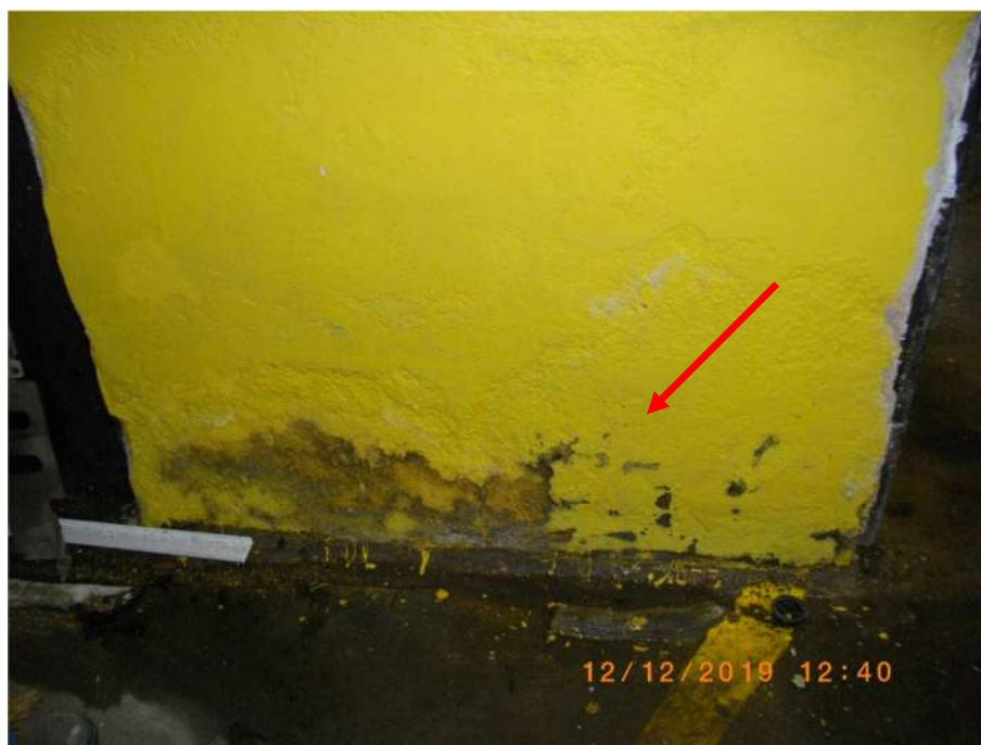
FOTO 60 - INFILTRAÇÃO NO CANTO INFERIOR DO PILAR 18 E NO PISO- - COM REPARO
