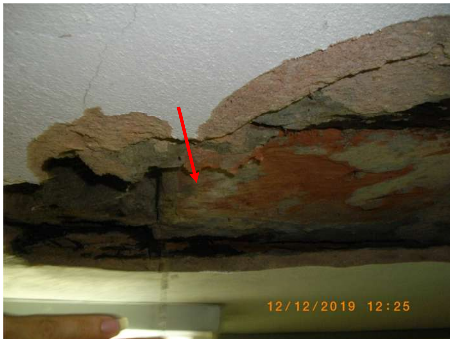
FOTO 39 - 1º TRECHO - CONCRETO DESAGREGADO E ARMADURA OXIDADA EXPOSTA NAS VISITAS NO TETO DA SALA ANTES CITADA
