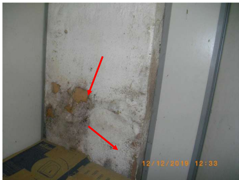
FOTO 48 - DANOS E INFILTRAÇÃO NO PILAR 16 VISTA POR DENTRO DA SALA DE ESTOQ. INFOR.
