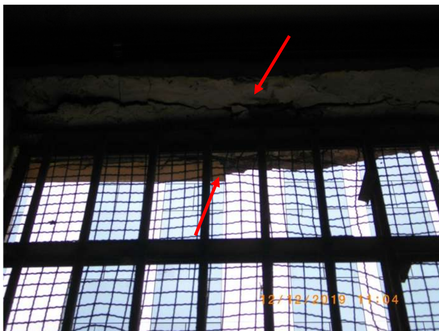
FOTO 02 - TRECHO DA VIGA 03 COM O CONCRETO DESAGREGADO E A ARMADURA OXIDADA EXPOSTA - EXTERNA E INTERNAMENTE
