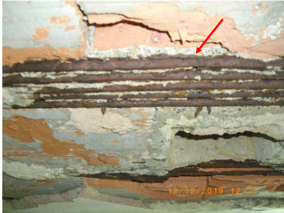
FOTO 41- 3º TRECHO - CONCRETO DESAGREGADO E ARMADURA OXIDADA EXPOSTA NAS VISITAS NO TETO DA SALA ANTES CITADA
