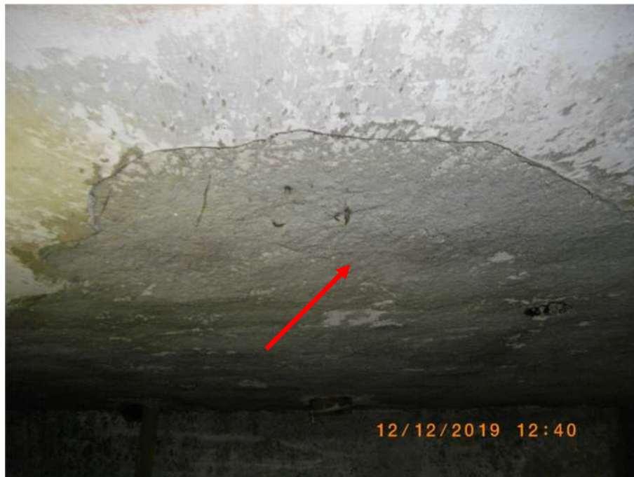
FOTO 59 - REPARO INDEVIDO NA LAJE EM CIMA DA CISTERNA DA DIREITA NA ÁREA ANTERIORMENTE MENCIONADA
