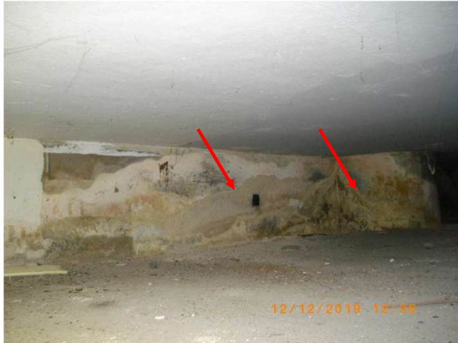
FOTO 55 - INFILTRAÇÃO NA PAREDE DE FUNDOS E NO PILAR 26 NA ÁREA ANTES CITADA EM CIMA DA CISTERNA DA ESQUERDA
