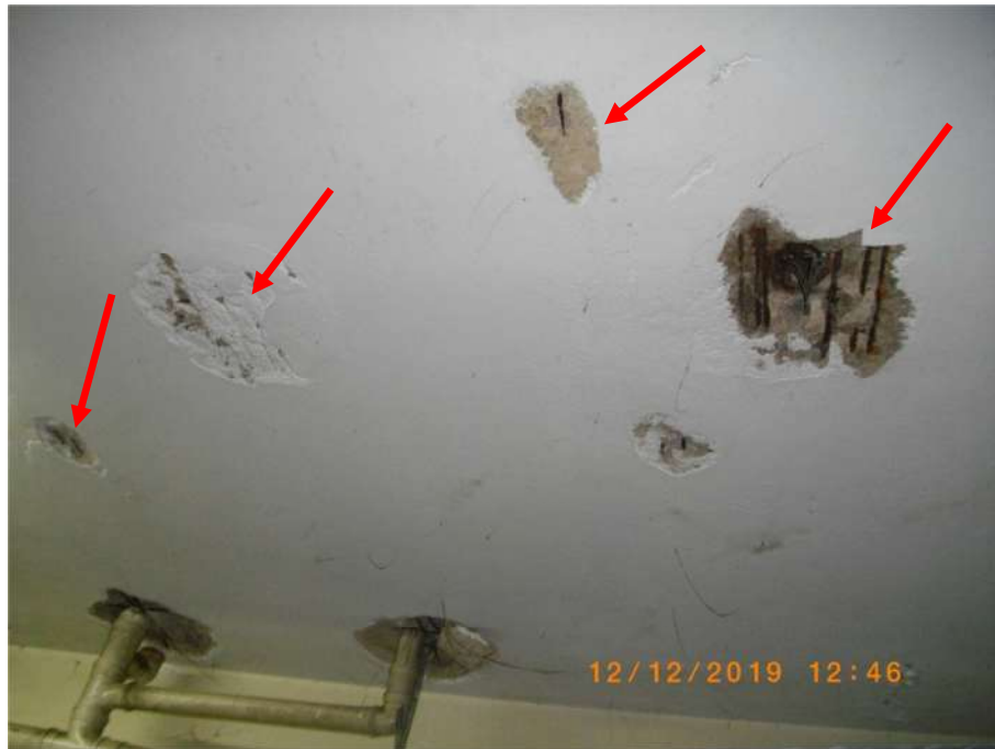
FOTO 69 - OUTROS DANOS NA LAJE ANTES CITADA (PRÓX AO PILAR 07) ALGUNS COM ARMADURADA OXIDADA EXPOSTA
