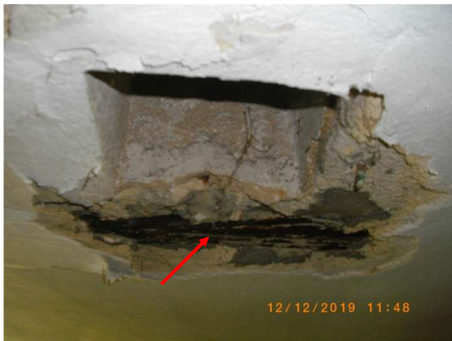
FOTO 24 - ARMADURA OXIDADA EXPOSTA NA 4ª VISITA NO TETO DA ÁREA ACIMA CITADA (PRÓX. AO P 22)
