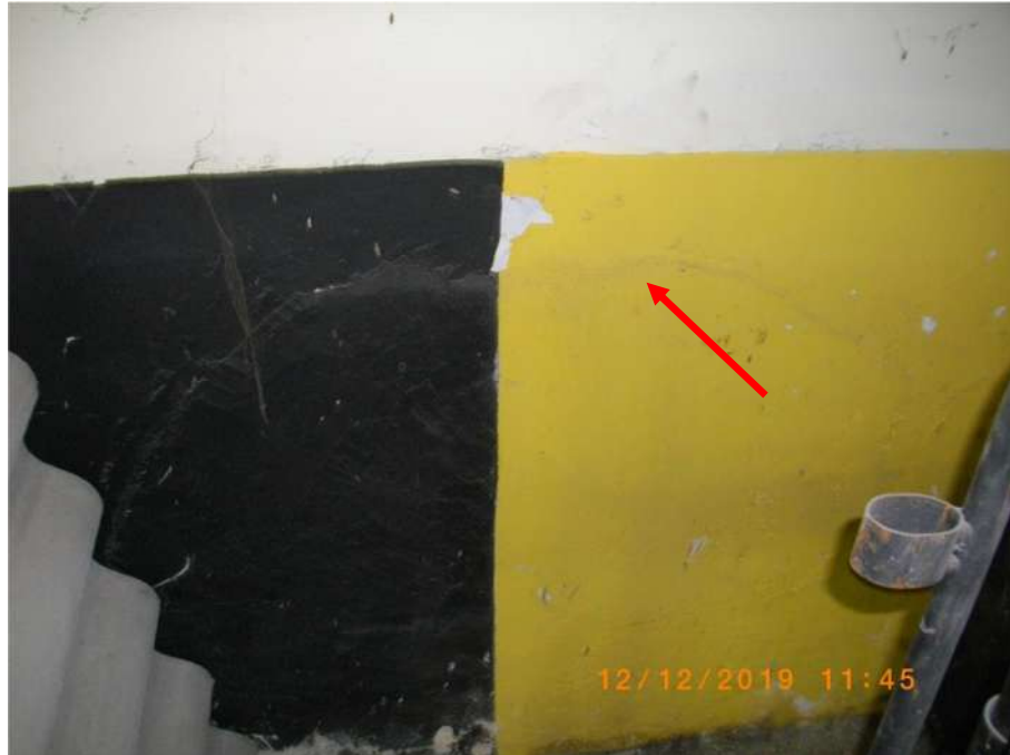
FOTO 21 - FISSURA NO CANTO ESQUERDO DA PAREDE DE FUNDOS DA SALA ANTERIORMENTE MENCIONADA
