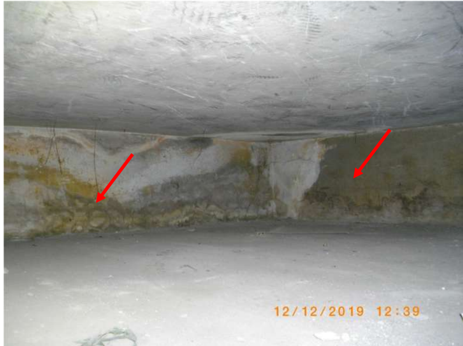
FOTO 57 - INFILTRAÇÃO NA PAREDE DE FUNDOS E DA DIREITA NA ÁREA ANTES CITADA EM CIMA DA CISTERNA DA DIREITA
