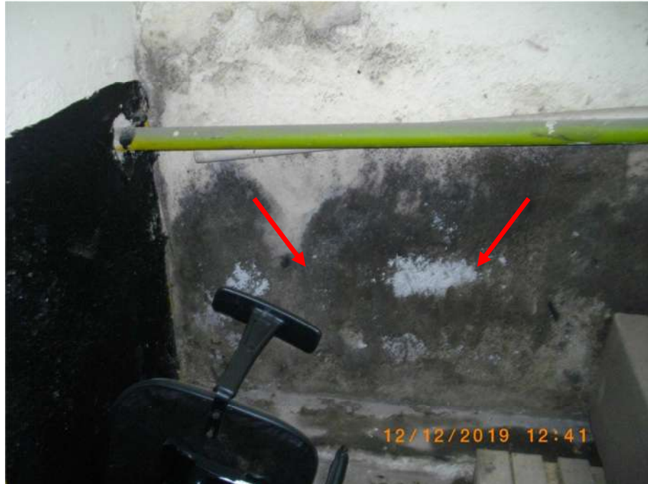
FOTO 67 - DETALHE NO CANTO INFERIOR ESQUERDO DE INFILTRAÇÃO GENERALIZADA NA PAREDE LATERAL DIREITA DO SUBSOLO
