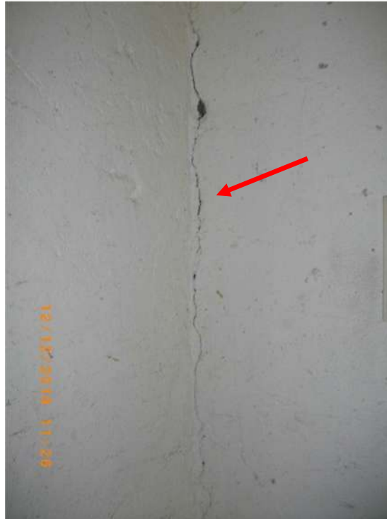
FOTO 13 - FISSURA NO ENCONTRO DAS PAREDES DE ENTRADA E LATERAL ESQUERDA DA SALA ANTERIORMENTE CITADA
