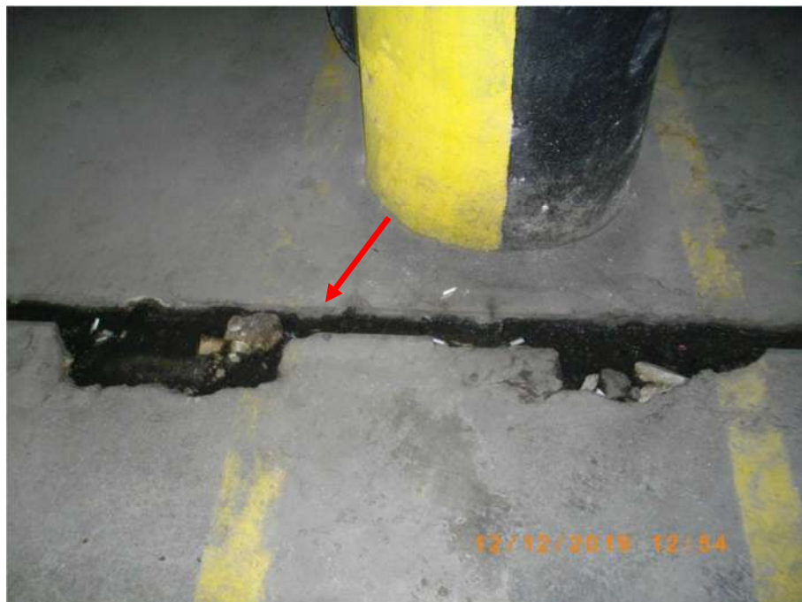
FOTO 74 - OUTROS DANOS NA CANALETA DO PISO DO SUBSOLO (PRÓX AO PILAR 02)
