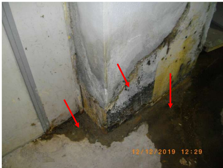
FOTO 46 - INFILTRAÇÃO NO CANTO ESQUERDO DO PISO E DO PILAR 16 - COM REPARO
