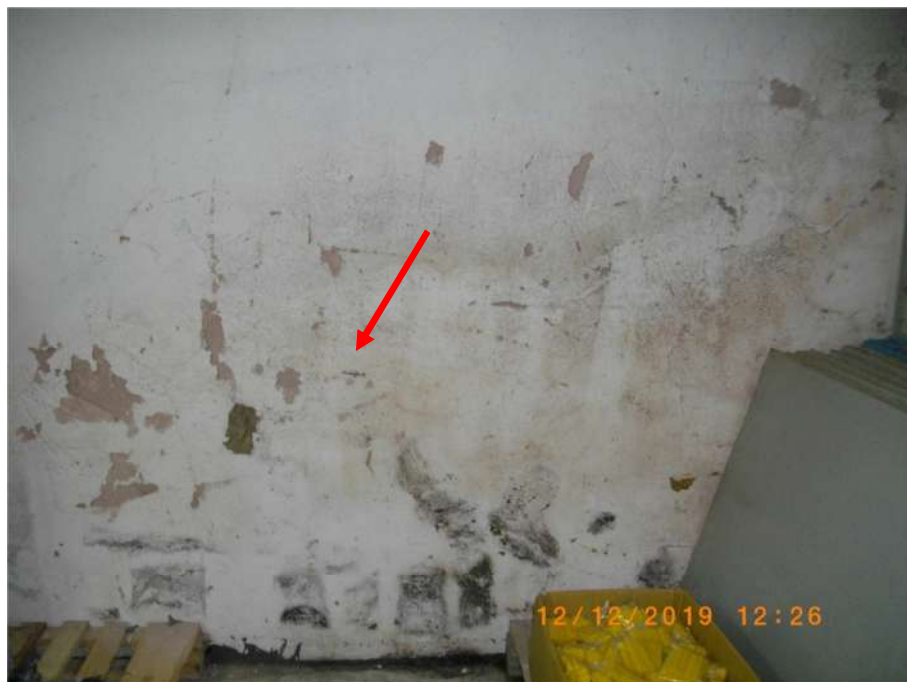
FOTO 44 - INFILTRAÇÃO NA PAREDE DE FUNDOS DA MESMA SALA
