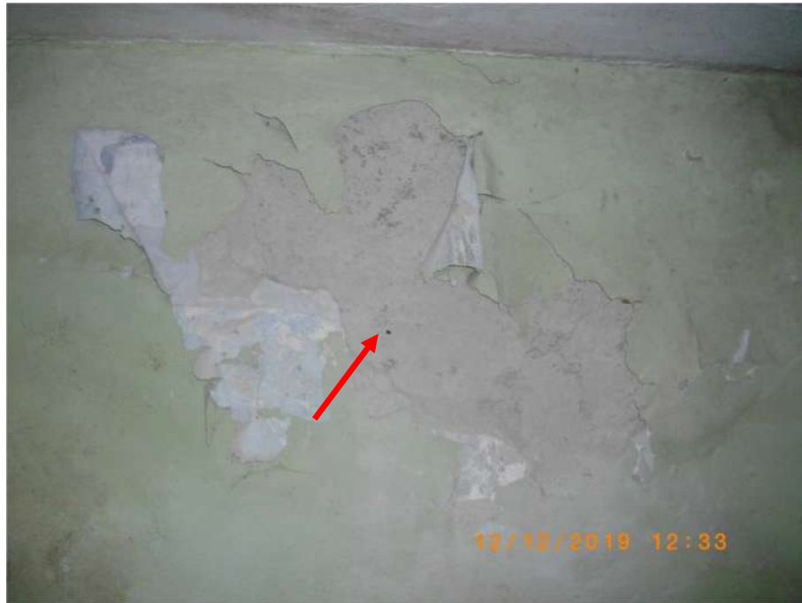
FOTO 53 - PULVERULÊNCIA NA PAREDE DE FUNDOS DA MESMA SALA
