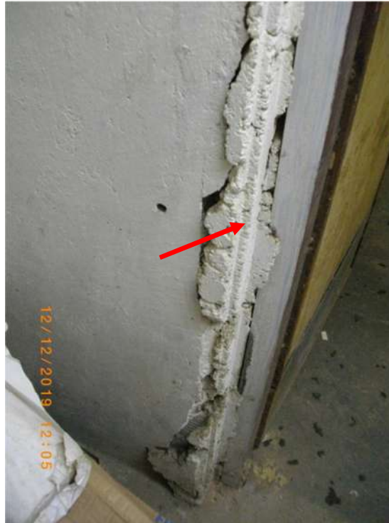
FOTO 33 - DANOS NÃO ESTRUTURAIS NA PAREDE À DIREITA DA PORTA NA SALA DE MAT. ENGENH.
