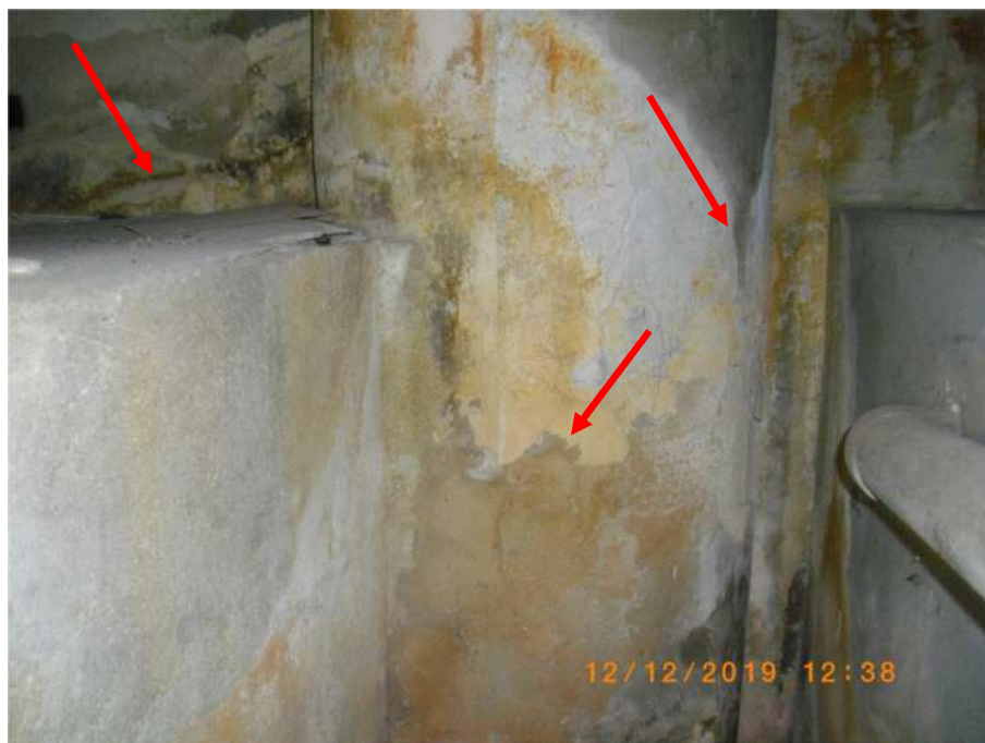
FOTO 56 - DETALHE DA INFILTRAÇÃO ACIMA NO CANTO DIREITO DO PILAR 26 ENTRE AS CISTERNAS
