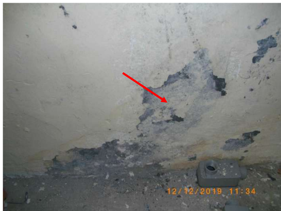
FOTO 18 - INFILTRAÇÃO JUNTO AO PISO NO CANTO DIREITO DA PAREDE ACIMA CITADA
