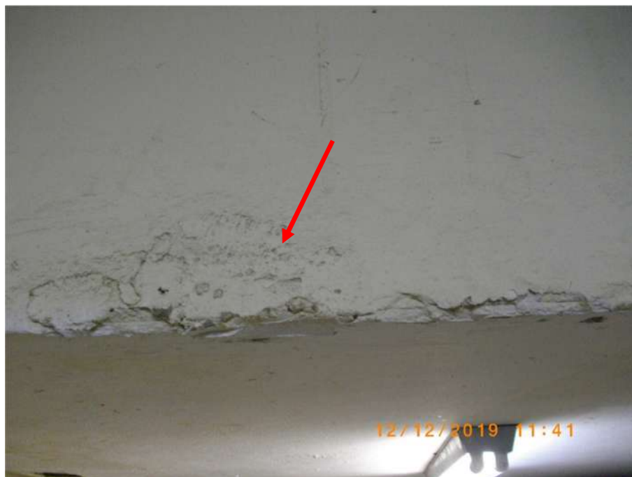
FOTO 19 - DANOS NÃO ESTRUTURAIS NO 1º VÃO DA VIGA 02 NA ÁREA ENTRE O FERRAMENTAL E O DEP. TRANS.
