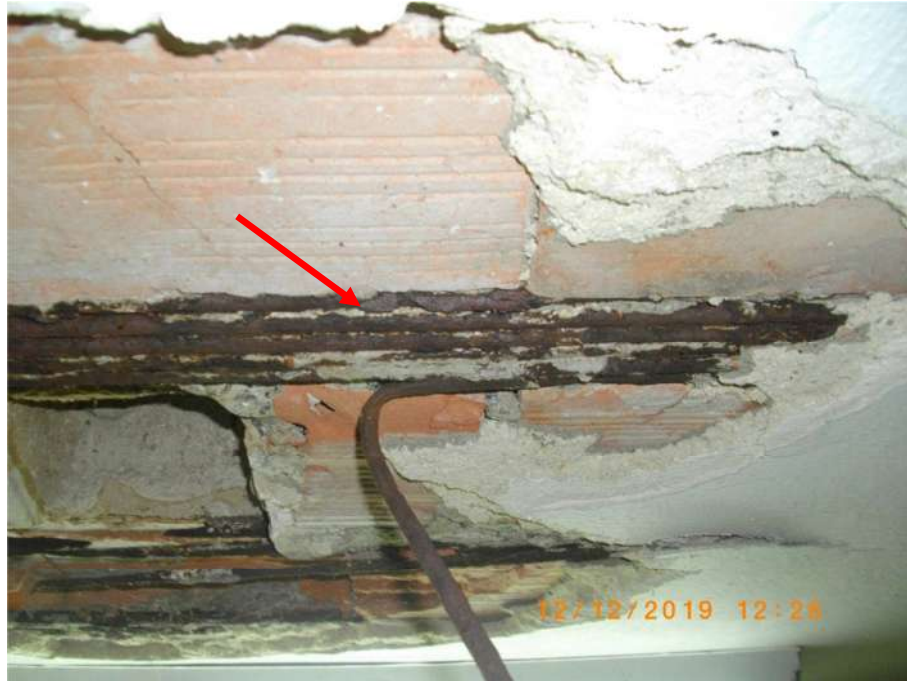
FOTO 43- 5º TRECHO - CONCRETO DESAGREGADO E ARMADURA ROMPIDA NA VIGA NO TETO DA SALA ANTES CITADA
