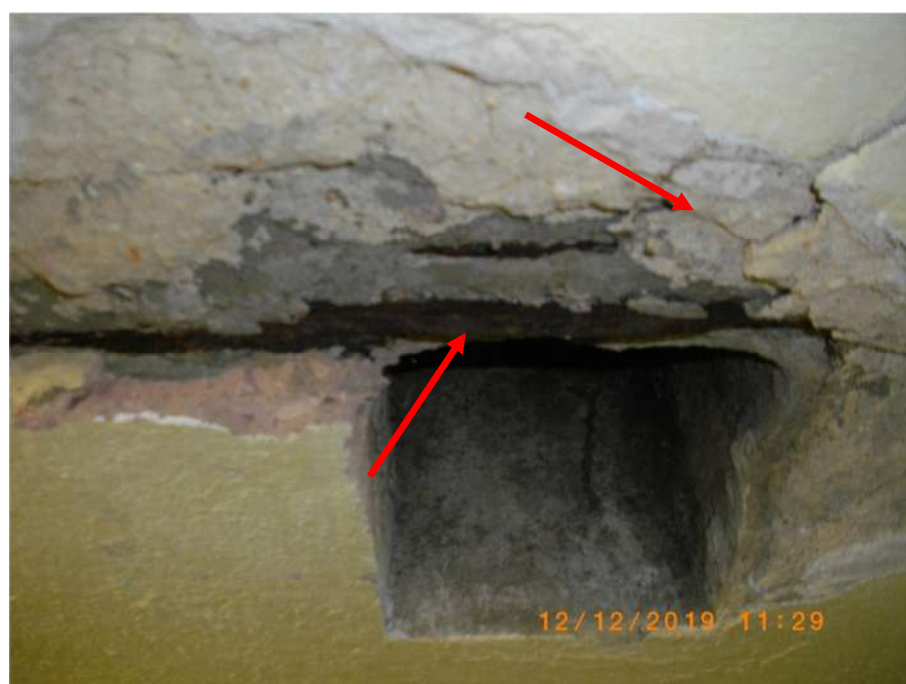
FOTO 14 - CONCRETO DESAGREGADO E ARMADURA OXIDADA EXPOSTA NA 2ª VISITA NO TETO DA SALA DO FERRAMENTAL
