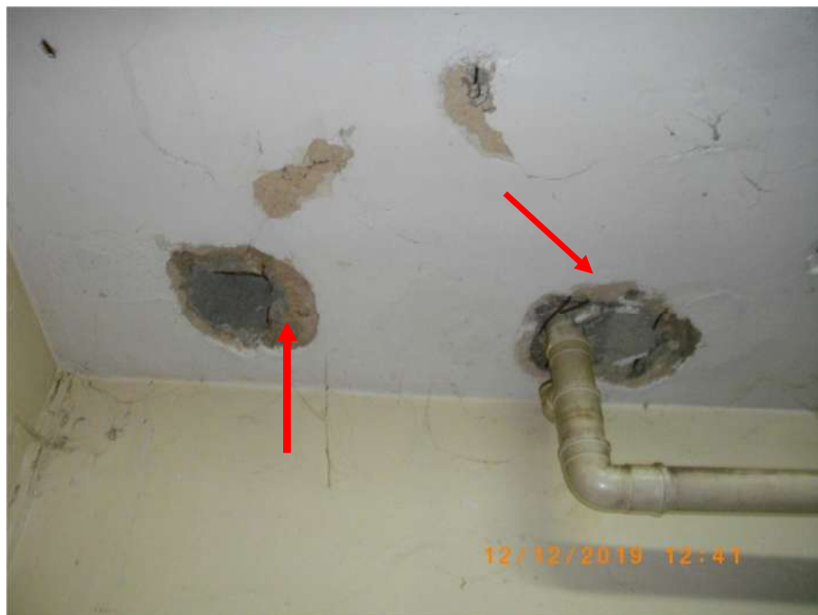
FOTO 68 - DANOS NA LAJE CONTÍGUA À PAREDE ACIMA MENCIONADA
