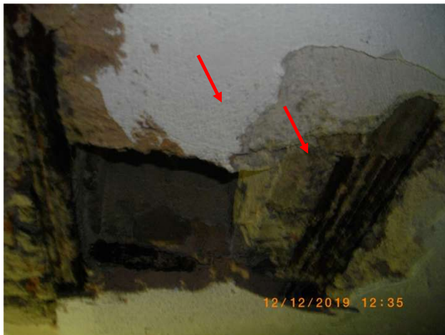
FOTO 54 - CONCRETO SOLTO E ARMADURA OXIDADA EXPOSTA NA 4ª VISITA NO CANTO ESQUERDO DO TETO NA ÁREA DAS CISTERNAS
