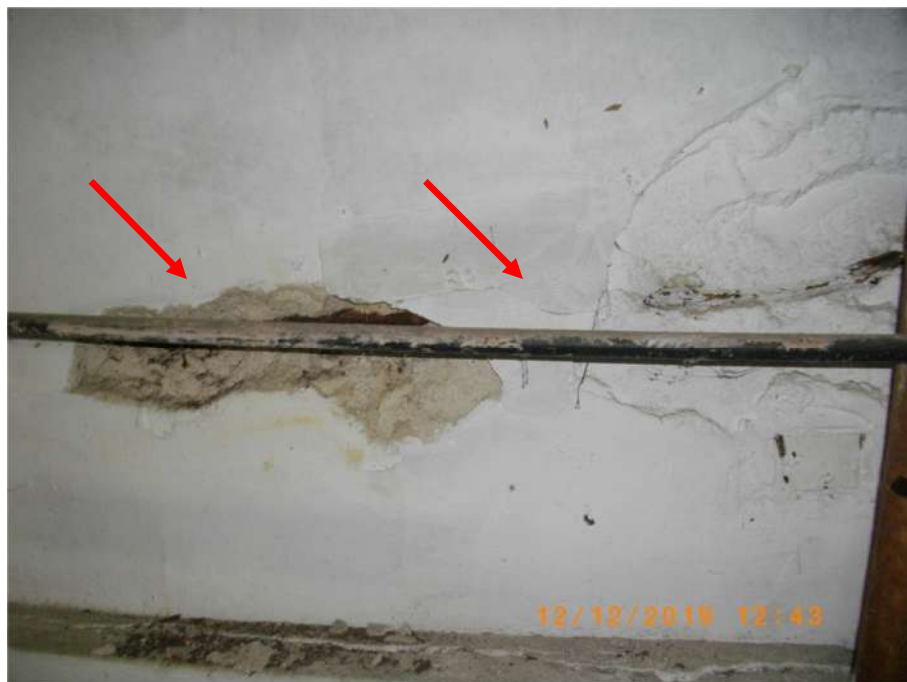
FOTO 64 - DANOS NA PAREDE LATERAL DIREITA DA MESMA SALA
