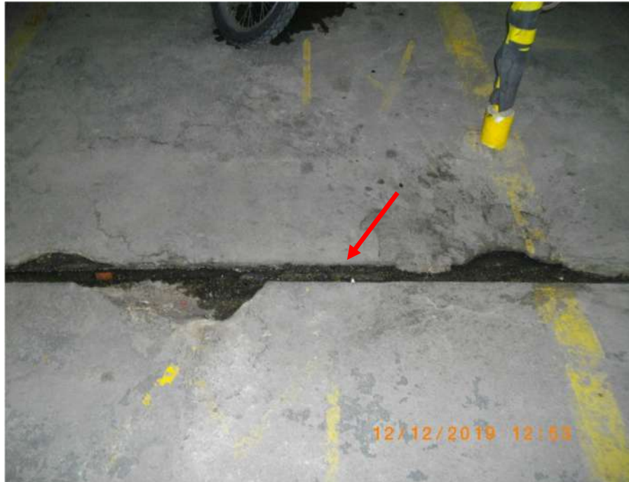
FOTO 75 - MAIS DANOS NA CANALETA DO PISO DO SUBSOLO (ENTRE OS PILARES 02 E 01)
