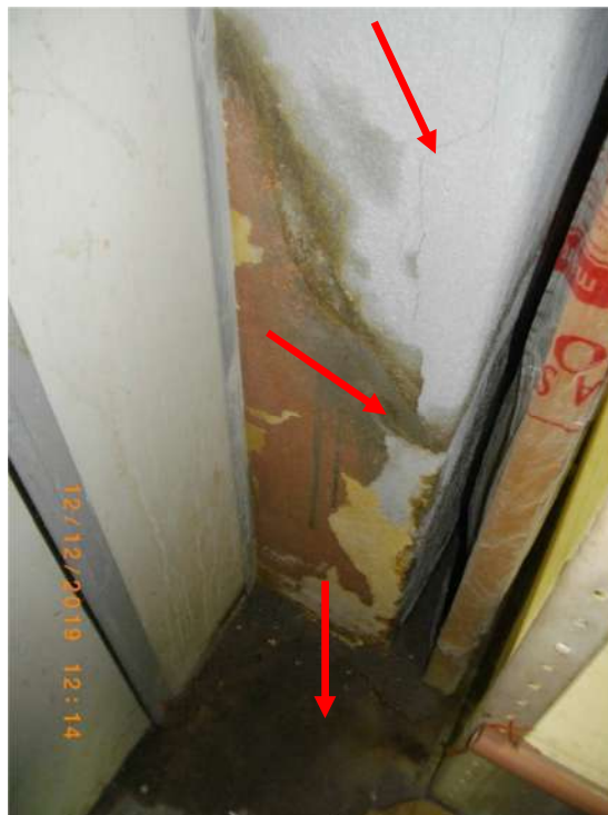
FOTO 34 - INFILTRAÇÃO NO PISO E NO PILAR 14 - FISSURA NO REPARO
