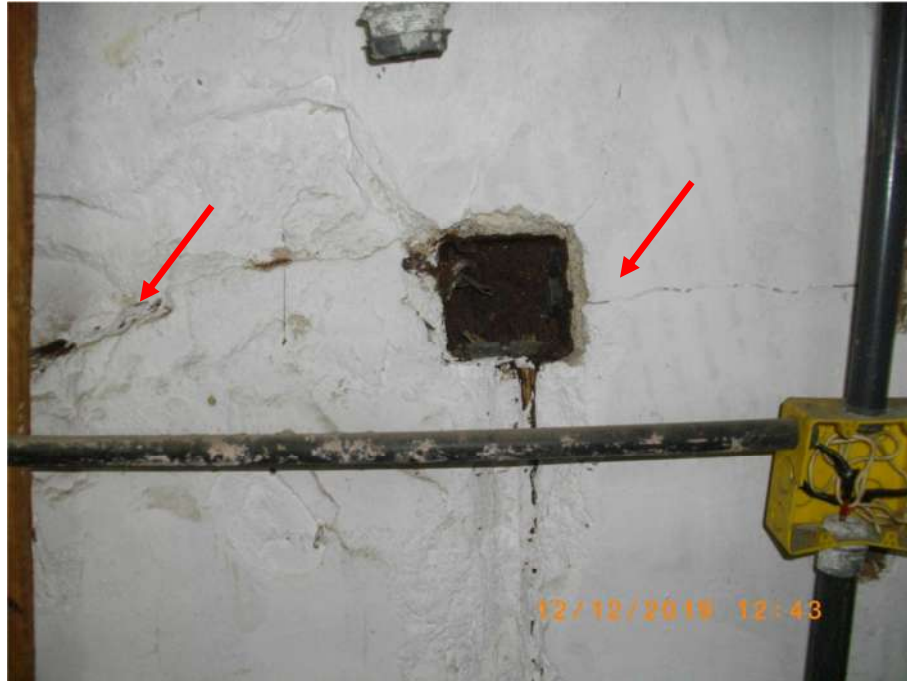
FOTO 65 - CONTINUAÇÃO DOS DANOS E FISSURA NA PAREDE ANTERIORMENTE CITADA
