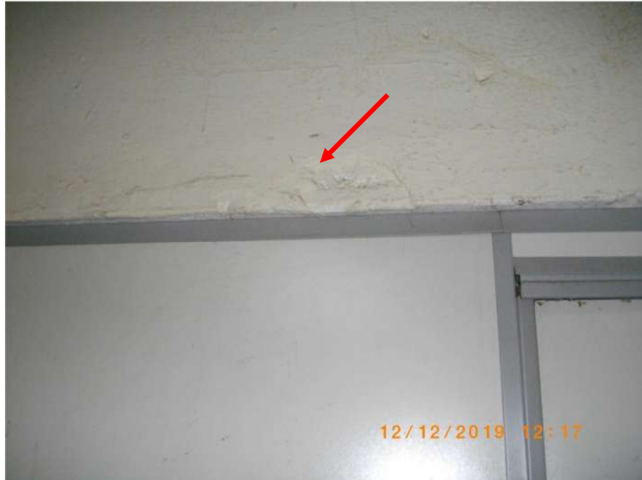
FOTO 35 - DANOS NÃO ESTRUTURAIS NA VIGA 02 ENTRE PILAR 14 E PILAR 15
