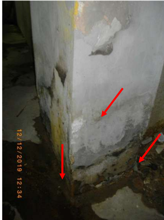
FOTO 47 - INFILTRAÇÃO NO CANTO DIREITO DO PISO E DO PILAR 16 - COM REPARO
