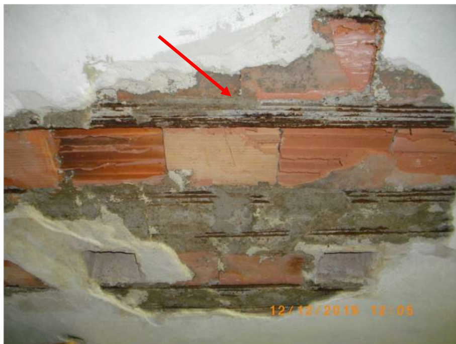
FOTO 32 - TRECHO FINAL - CONCRETO DESAGREGADO E ARMADURA OXIDADA EXPOSTA NAS VISITAS NO TETO DA MESMA SALA
