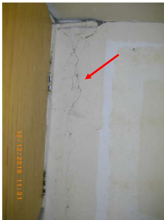
FOTO 16 - TRINCA CONTÍNUA NA PAREDE LATERAL ESQUERDA DA SALA ACIMA
