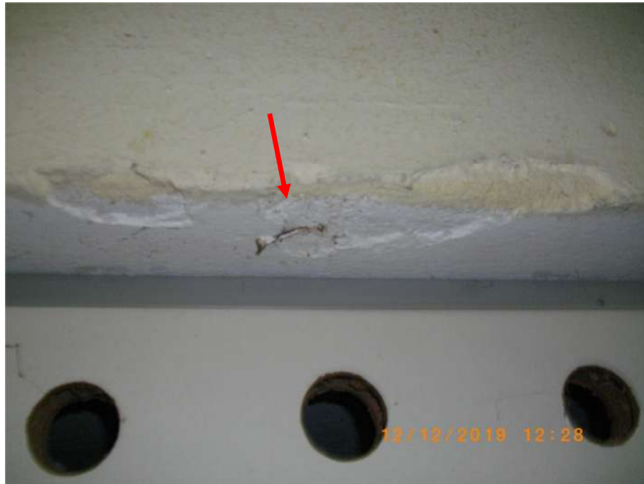
FOTO 45 - DANOS NÃO ESTRUTURAIS NA VIGA 02 ENTRE PILAR 15 E PILAR 16
